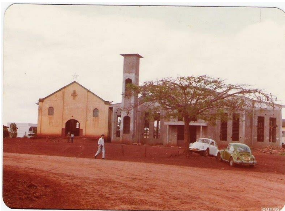
Figura 9 - Início da construção da Igreja Matriz de Lunardelli, na década de 1980. Fonte: Santuário (2015).
