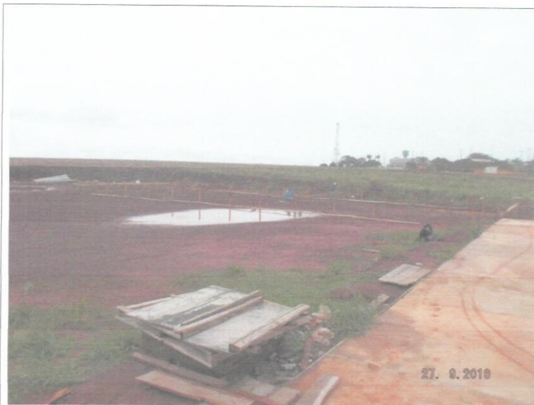
Foto 01: Canteiro de obras no mês de Setembro, sem condições de trabalho.
