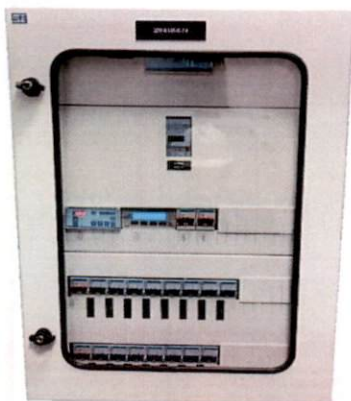
Detalhe: Quadro de distribuição TTW-QD
